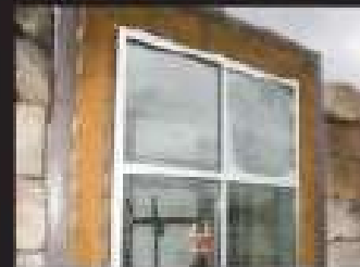
Patlamadan Sonra (Çiydirme Cephe)
