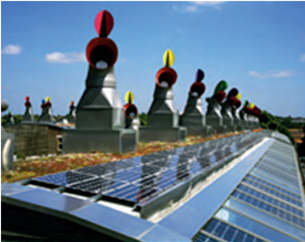
Şekil 3: PV panellerden görünüm [5]
