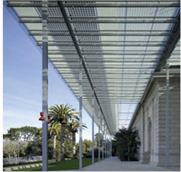
Şekil 4: Yapı saçağında bulunan PV paneller [7]
